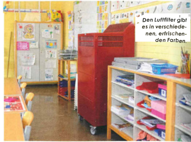
Mit einem Gerät wird der geforderte Luftaustausch bei einem Raumvolumen von bis zu 132 Kubikmetern erreicht.
