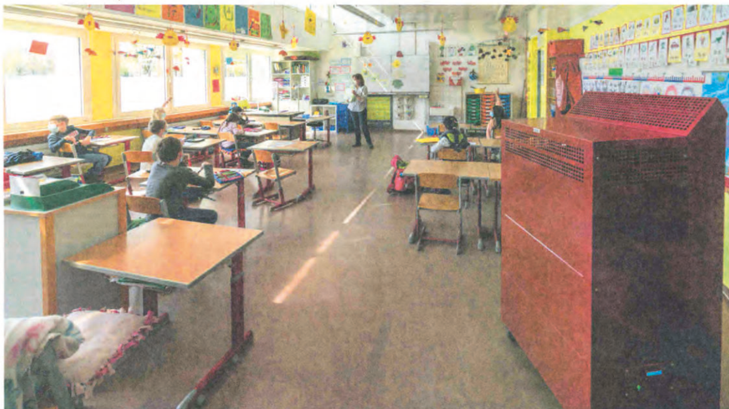
Luftreiner Hepasafe in der Steinhöwel-Schule in Weil der Stadt: Dieses Pilotprojekt wurde lange vor einer politischen Entscheidung umgesetzt.
